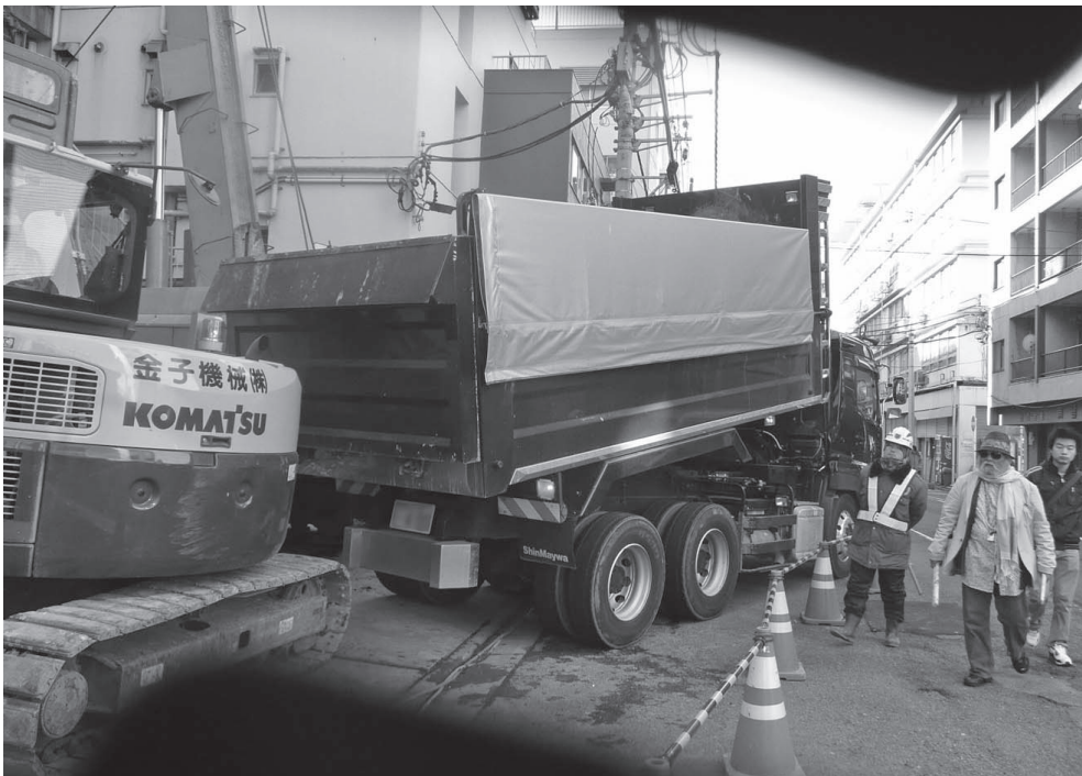
違法改造車両のダンプに残土を積み込む民間工事の現場（1月28日神奈川県横浜市内）
