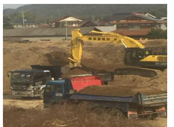
指導の目が届かないところでは過積載はやりたい放題のところもあり（県内の公共工事現場で2018年1月組合撮影）
