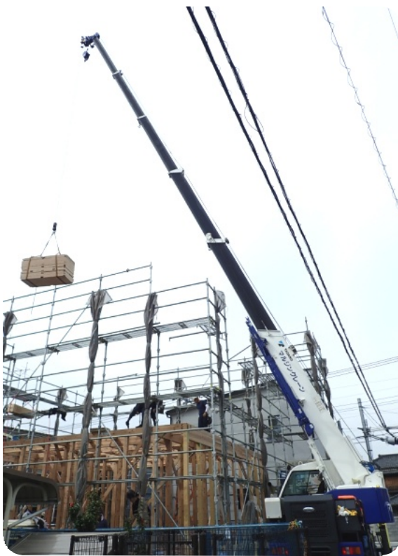
新築現場で資材を釣り上げているところ。作業員の動き、交通状況、電線の位置や風力など細心の注意が必要です。
